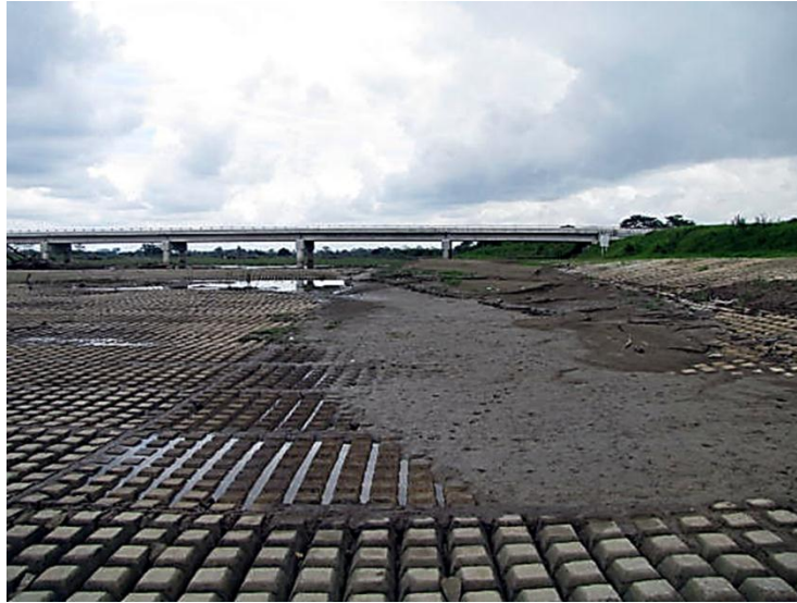
Figura 3. Sedimentos depositados en la margen derecha del canal derivador, El Censo.
