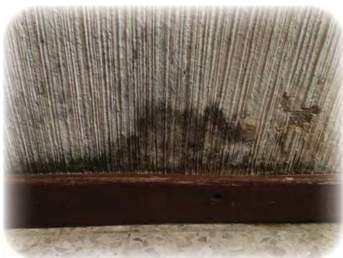
Fotografía 2. Moho en las paredes de los baños, donde hay mucha humedad.
