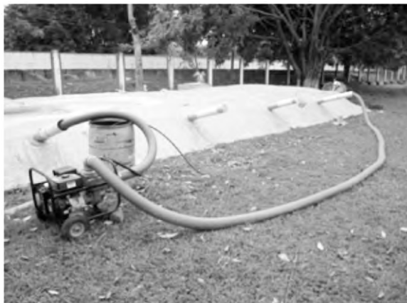
Proceso de agitación mecánica del biodigestor tipo cúpula.
