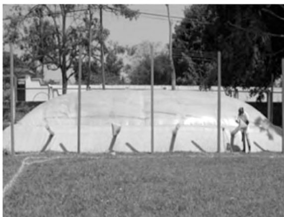
Figura 1. Biodigestor anaerobio tipo cúpula de la DACBiol.
